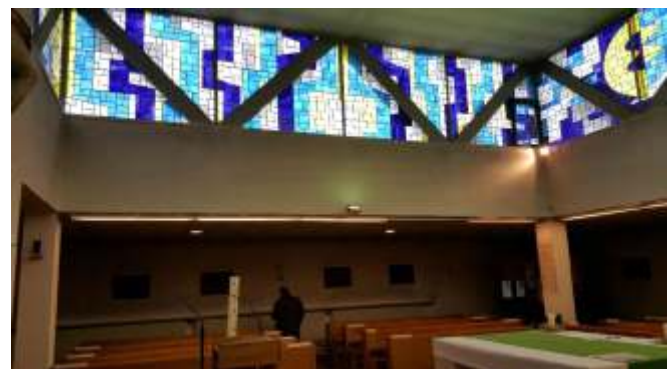
Das Foto belegt die Dringlichkeit der Renovierung!
